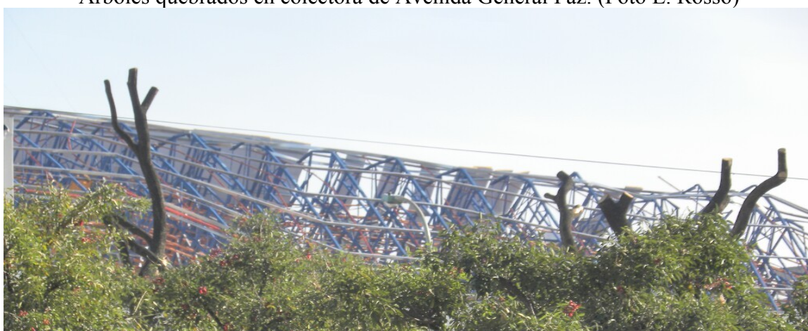
Techo de galpón desplazado de su base en Lisandro de la Torre y Directorio. (Foto L. Rosso)
