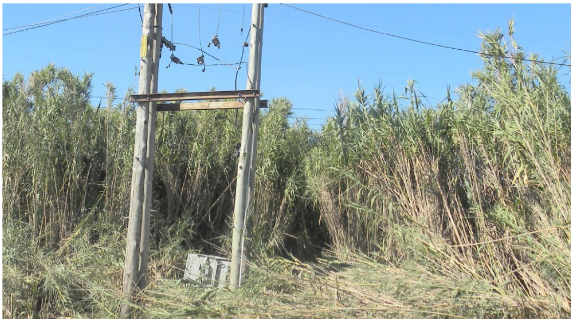
Transformador caído en zona rural de Florencio Varela (Foto L. Rosso)
