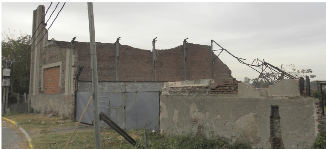
Paredes derrumbadas y techo volado en Avellaneda (Foto L. Rosso)
